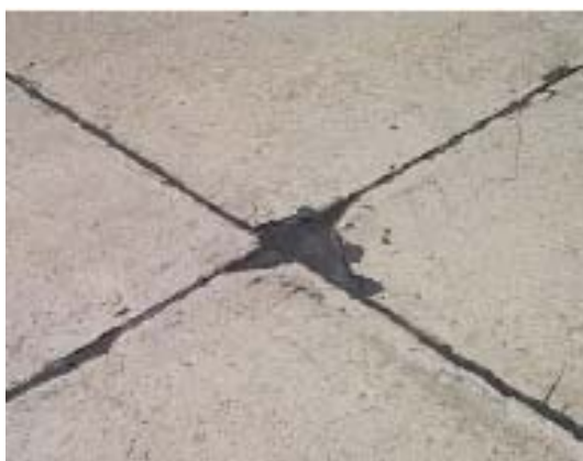
FIG. X2.13 Bacheos menores de Baja severidad
