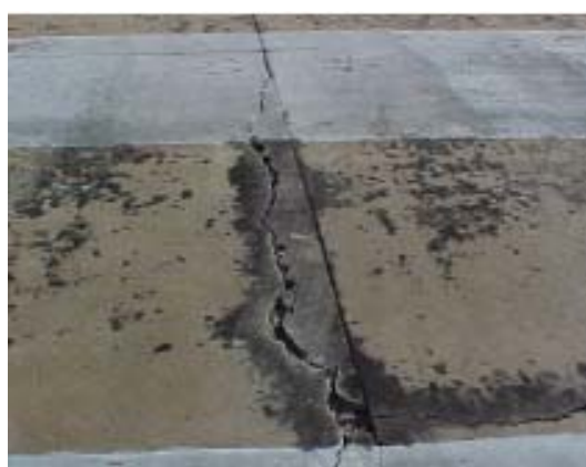
FIG. X2.32 Desprendimiento de media severidad
