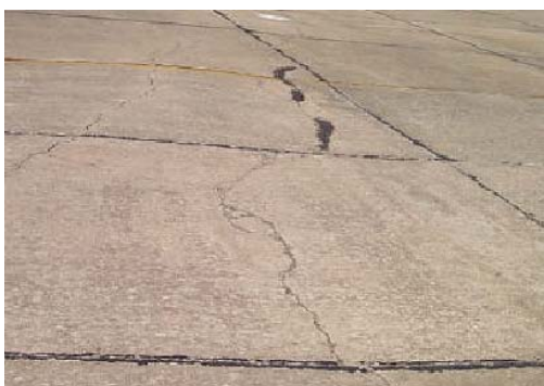
FIG. X2.4 Fisuras L&T de severidad Baja
