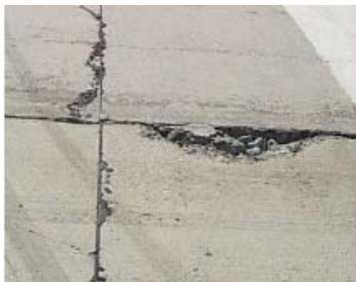
FIG. X2.33 Desprendimiento de alta severidad
