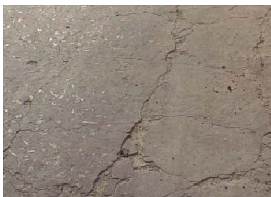
FIG. X2.22 Mapa de fisuras de severidad Media
