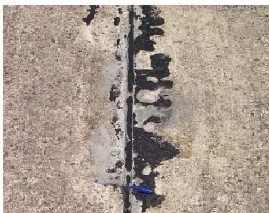
FIG. X.12 Daño sellado de junta de severidad Alta
