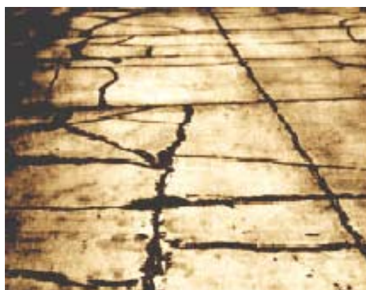
Fig. X2.29 Losa cuarteada de alta severidad
