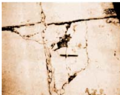
FIG. X2.36 Desprendimiento de esquina de severidad alta
