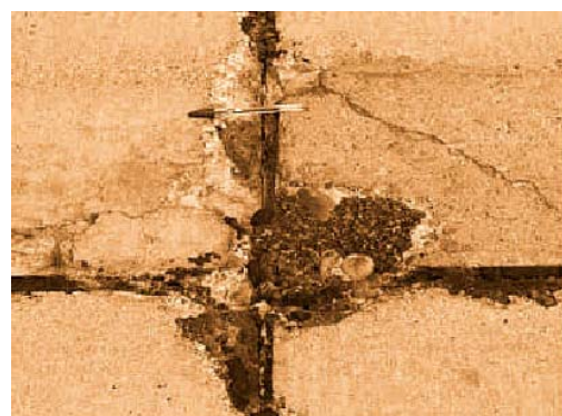
FIG. X2.3 Rotura de esquina de severidad Alta
