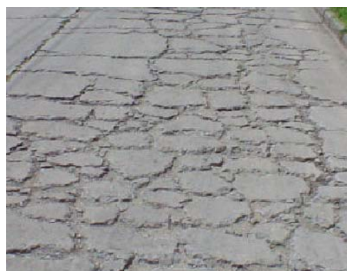
FIG. X2.23 Mapa de fisuras de severidad Alta
