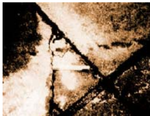
FIG. X2.35 Desprendimiento de esquina de severidad media
