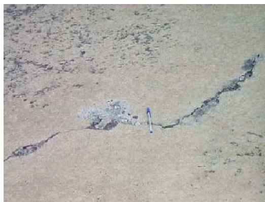
FIG. X2.6 Fisuras L&T de severidad Alta
