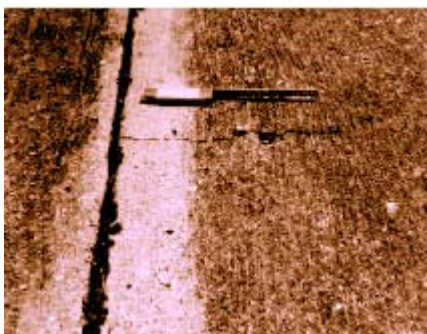
Fig. X2.30 Fisuras por contracción
