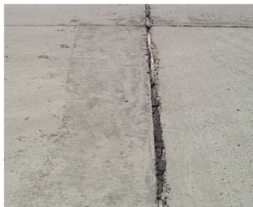
FIG. X2.11 Daño sellado de junta de severidad
