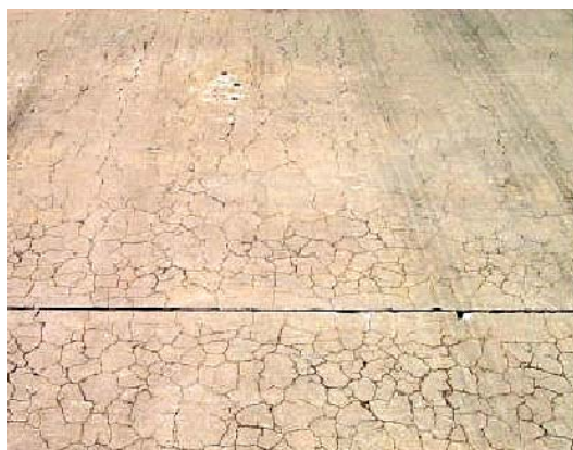
FIG. X2.21 Mapa de fisuras de severidad Baja
