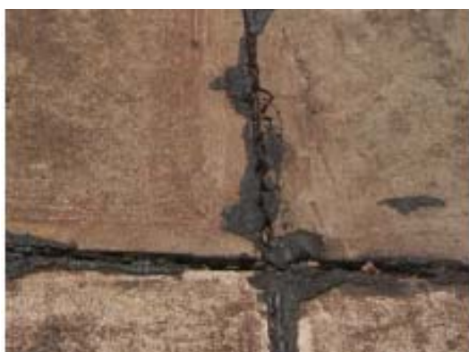
FIG. X2.31 Desprendimiento de baja severidad
