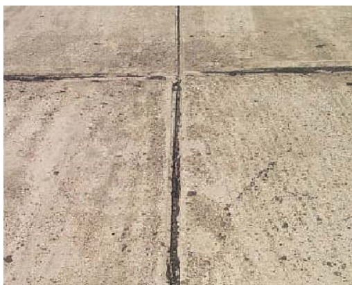
FIG. X2.10 Daño sellado de junta de severidad Baja
