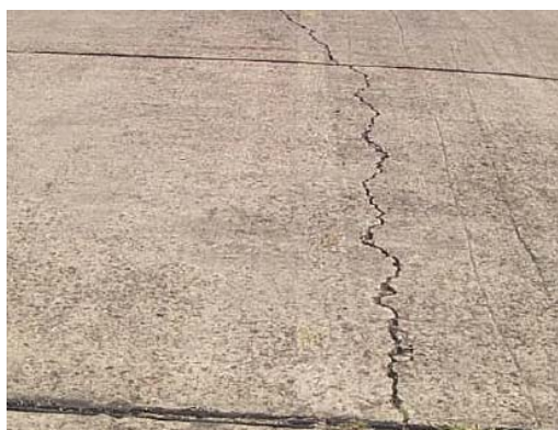
FIG. X2.5 Fisuras L&T de severidad Media
