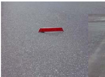
Depresión de Baja Severidad Low severity depression
