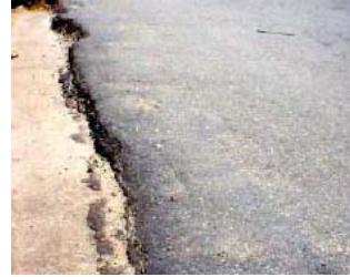
Ondulación de Alta Severidad High Severity Shoving
