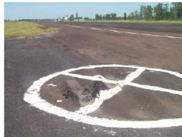
Ahuellamiento de Alta Severidad High severity rutting
