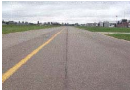
Fisuras Longitudinales y Transversales de Baja Severidad Low Severity Longitudinal and Transverse Cracking
