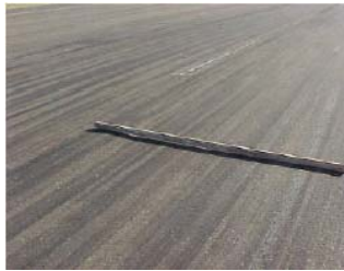
Ahuellamiento de Baja Severidad Low severity rutting
