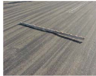
Ahuellamiento de Media Severidad Medium severity rutting
