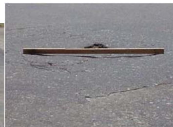
Depresión de Alta Severidad High severity depression
