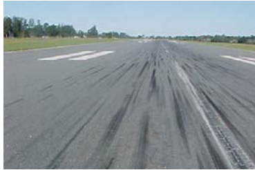
Piel de Cocodrilo de Baja Severidad Low Severity Alligator cracking
