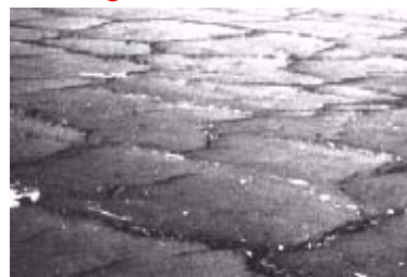
Fisuras en bloque de Alta Severidad High Severity Block cracking
