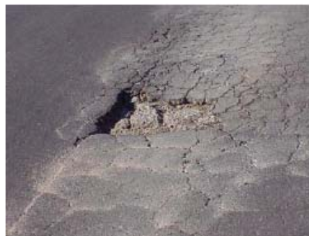
Piel de Cocodrilo de Alta Severidad High Severity Alligator cracking
