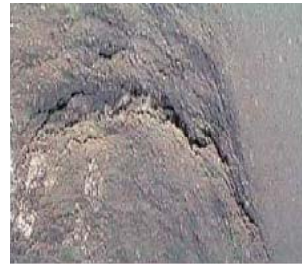
Fisuras por Deslizamiento Slippage Cracks
