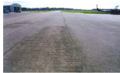
Piel de Cocodrilo de Media Severidad Medium Severity Alligator cracking
