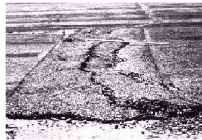
Hinchamiento de Alta Severidad Medium Severity Swelling
