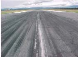
Fisuras en bloque de baja severidad Medium Severity Block Cracking
