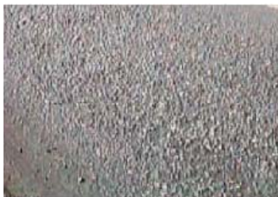
Peladura de Media Severidad Medium Severity Raveling
