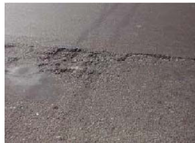
Peladura de Alta Severidad High Severity Raveling
