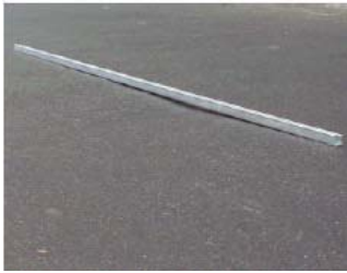
Ondulación de Media Severidad Medium Severity Corrugation
