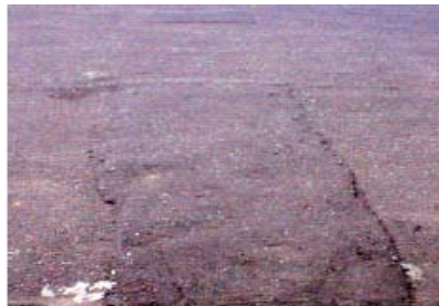
Hinchamiento de Media Severidad Medium Severity Swelling
