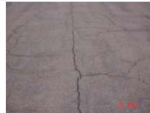
Fisuras en bloque de severidad media Medium Severity Block Cracking
