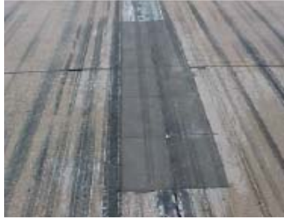
Bacheos mayores de Severidad Baja + Contaminantes
