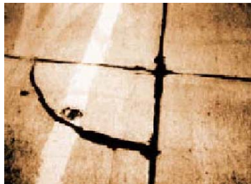
Rotura de esquina de Severidad Baja Low severity corner break
