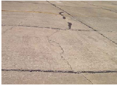
Fisuras L&T de Severidad Baja
