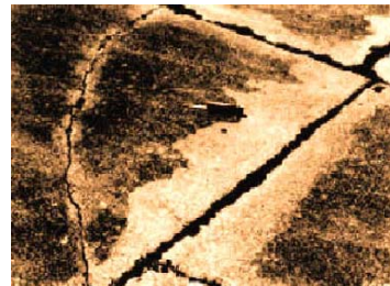
Rotura de esquina de Severidad Media Medium severity corner break
