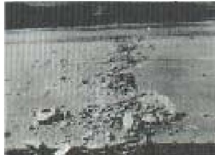
Blowups de Severidad Alta
