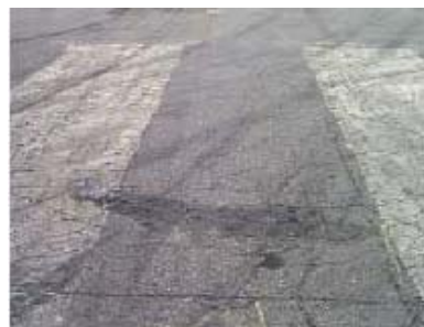
Bacheos mayores de Severidad Media + Agregados Pulidos
