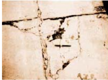
Desgranamiento de esquina de Severidad Alta
