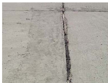
Daño sellado de junta de Severidad Media High Severity Joint seal damage
