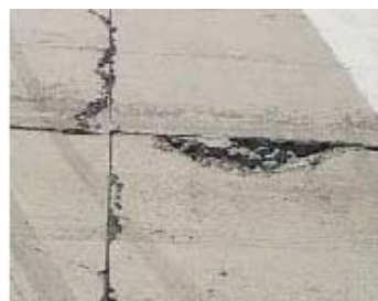
Desgranamiento de borde de Severidad Alta
