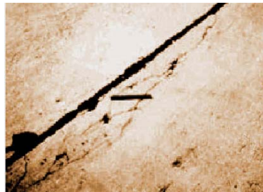
Fisura "D" de Severidad Media
