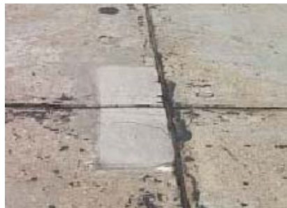
Bacheos menores de Severidad Media + Desgranamiento de esquina de Severidad Baja
