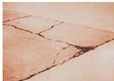
Losa colapsada de Severidad Media
