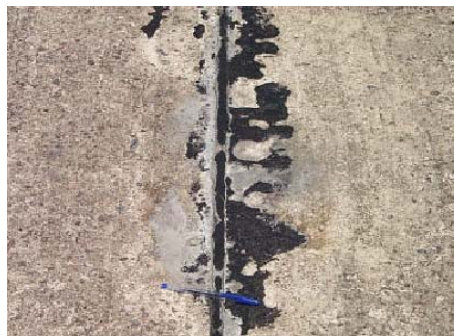
Daño sellado de junta de Severidad Alta
