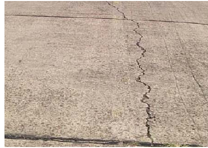
Fisuras L&T de Severidad Media
