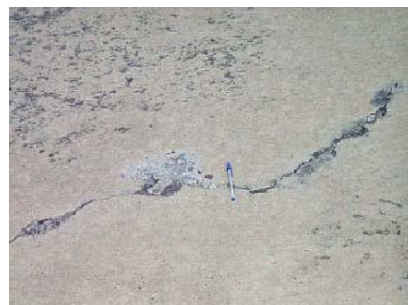
Fisuras L&T de Severidad Alta
