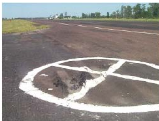
FIG. X1.33 Ahuellamiento de Alta Severidad
