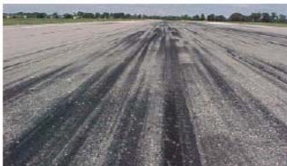
FIG. X1.15 Erosión por Ráfaga de Jet
