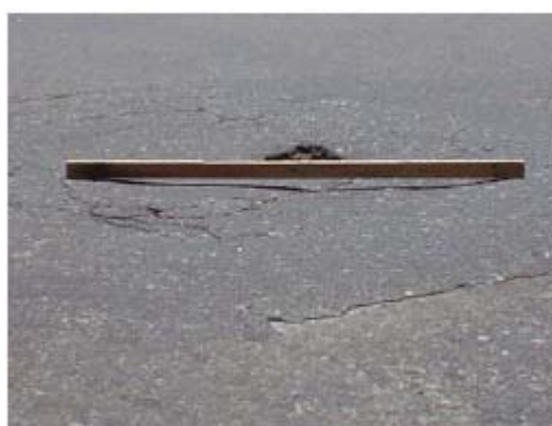
FIG. X1.14 Depresiones de Alta severidad
