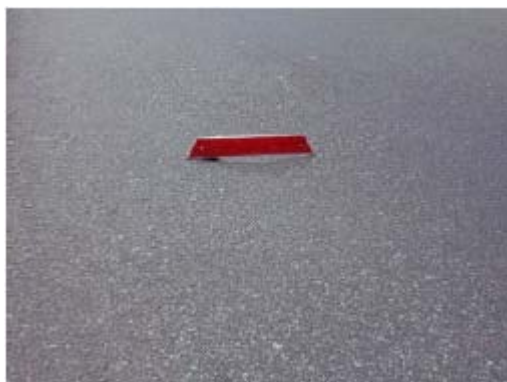
FIG. X1.12 Depresiones de Baja severidad
