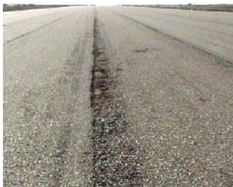
FIG. X1.22 Fisuras longitudinales y transversales de Alta severidad.
