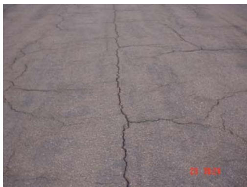
FIG. X1.7 Fisura de Bloque de severidad Media
