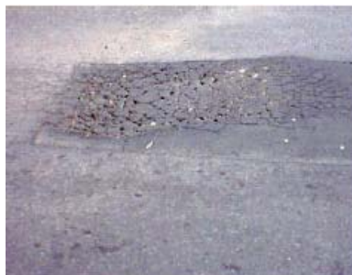
FIG. X1.25 Bacheo de Alta severidad.
