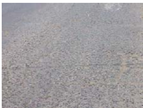
FIG. X1.28 Peladura de Baja severidad
