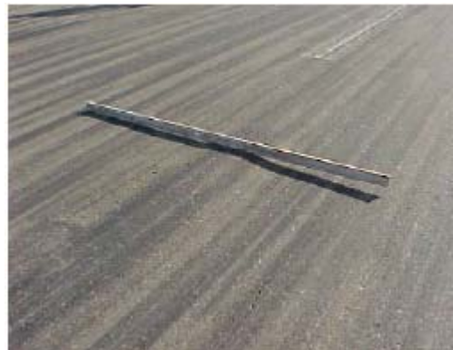
FIG. X1.32 Ahuellamiento de Alta Severidad
