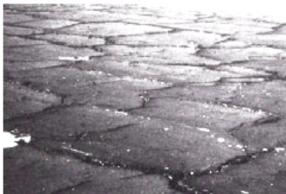
FIG. X1.8 Fisura de Bloque de Alta severidad
