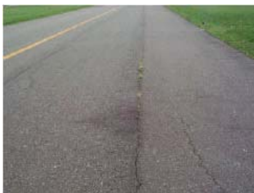
FIG. X1.21 Fisuras longitudinales y transversales de severidad Media
