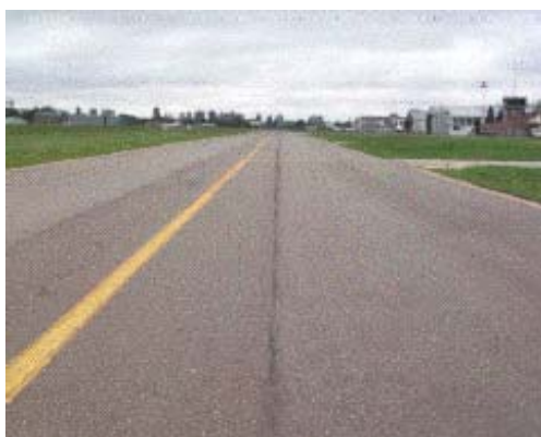
FIG. X1.20 Fisuras longitudinales y transversales de Baja severidad
