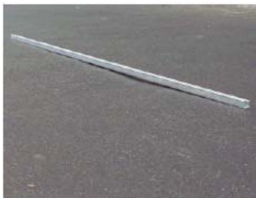
FIG. X1.10 Ondulación de severidad Media
