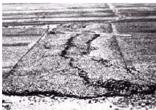
FIG. X1.40 Hinchamiento de Alta severidad
