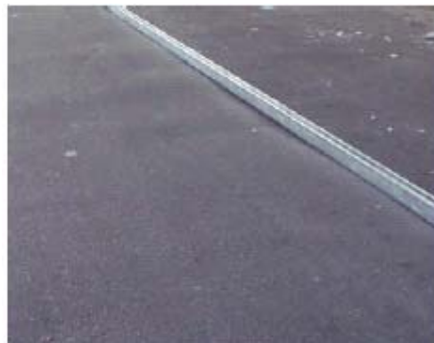
FIG. X1.11 Ondulación de Alta severidad
