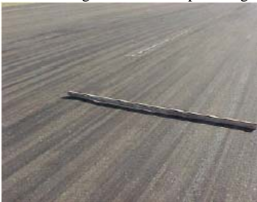
FIG. X1.31 Ahuellamiento de Media Severidad
